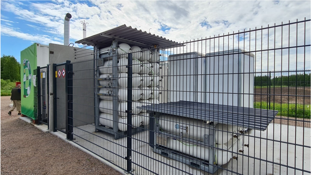
KUVIO 3. Tankkausaseman pullopatteristo, josta paineistettu biometaanitankataan autoihin. Kuva: Mikko Aalto
