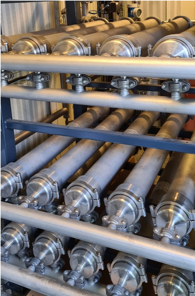
Kuvio 11. Membraanitekniikkaan perustuva jalostusyksikkö, jolla Etelä-Karjalan Jätehuollon biokaasu jalostetaan biometaaniksi liikennekäyttöön. Kuva Mikko Aalto
