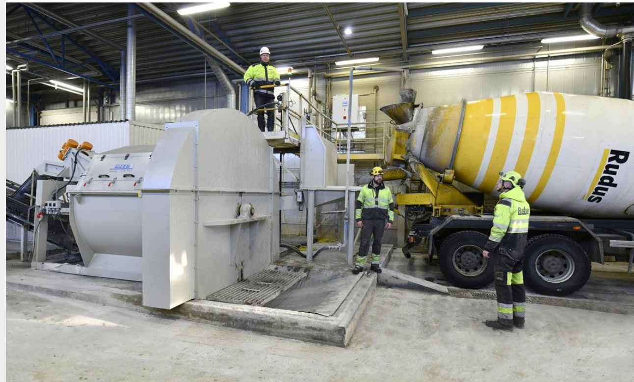
Kuva: Rudus Myllypuron betonitehtaan kierrätyslaite
